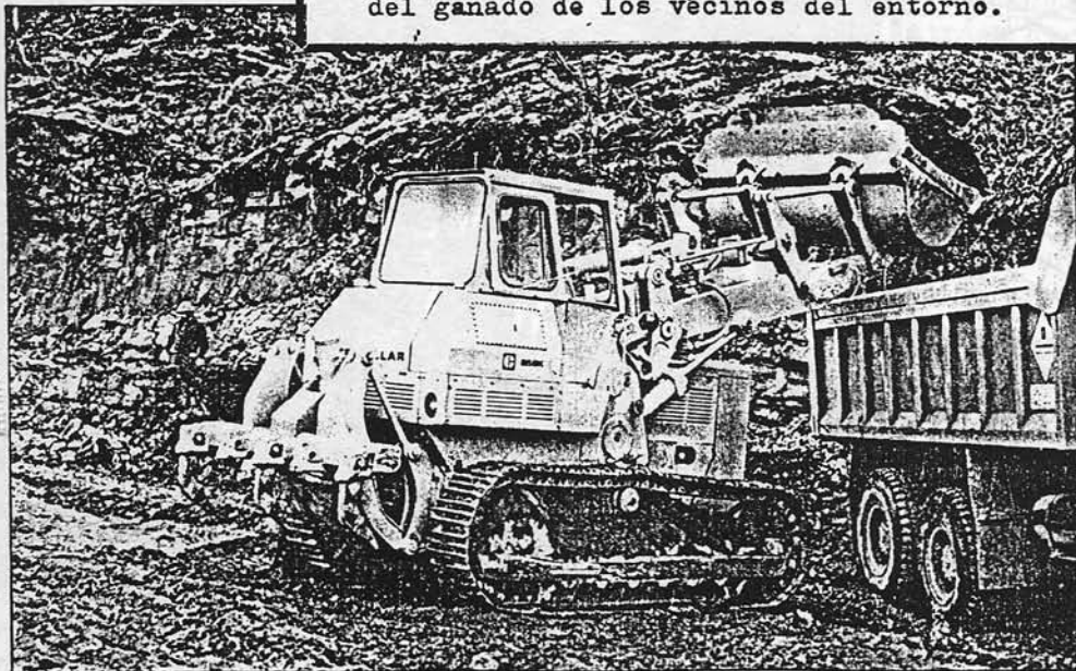
Iniciación de la explotación a cielo abierto (marzo del 77), sin picadores ni ramperos, con palas mecánicas y camiones.
