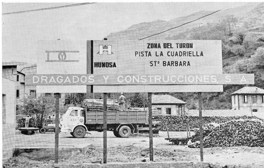
Pista La Cuadriella-Santa Bárbara.. Quede aquí el comienzo de las obras, que darán fin para últimos del verano u otoño.
