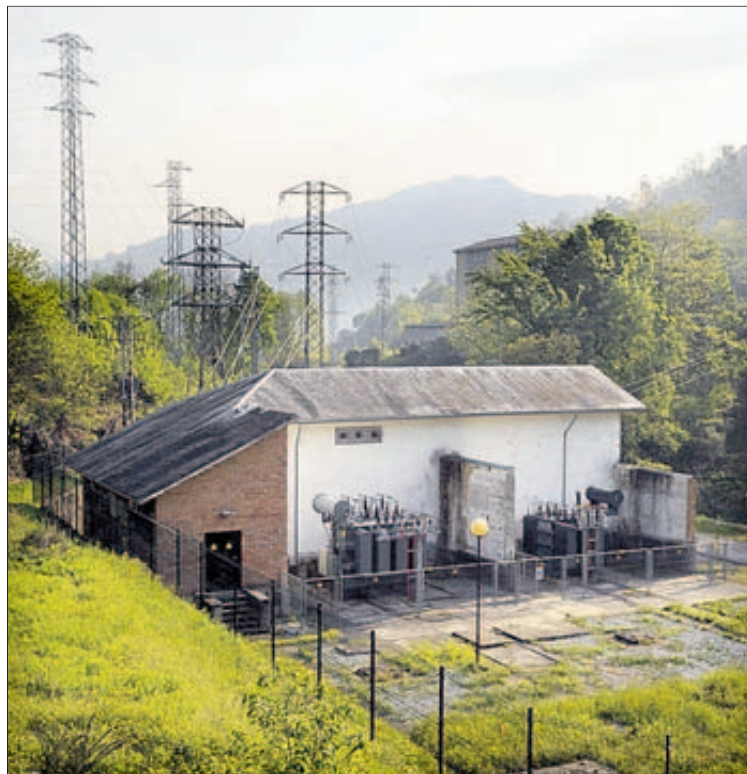
La subestación eléctrica de La Olla, en El Terronal. | J. R. SILVEIRA
