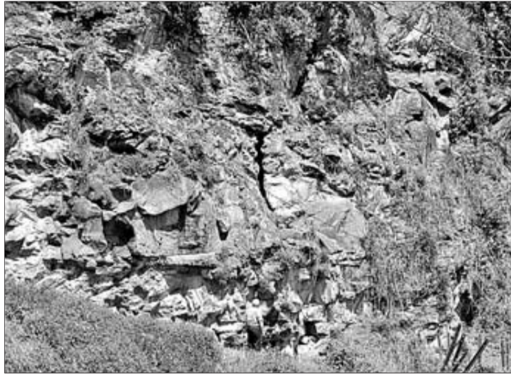
Un vecino, ante la piedra que presenta grietas en la base. | FERNANDO GEIJO
