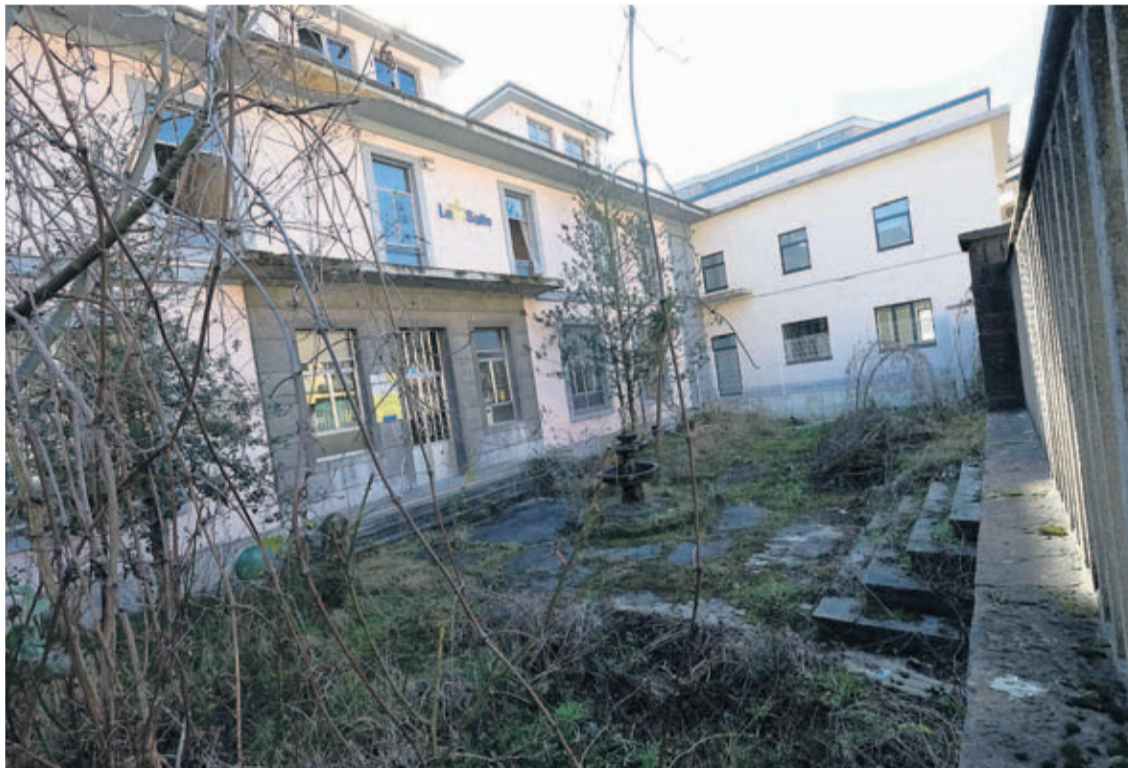
Maleza en el patio de entrada del colegio de La Salle; a la derecha, la parte que corresponde al consultorio periférico de Turón, que también se encuentra en el inmueble. | J. R. SILVEIRA
