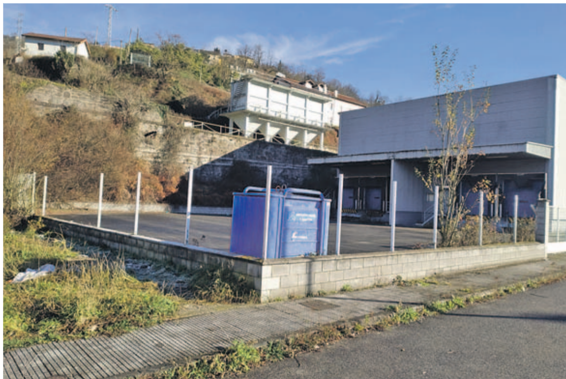
Instalaciones de Diasa, con el cierre sustraído tras años sin actividad ni vigilancia. | D. M.
